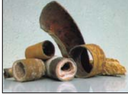
Taşlama ve korozyon sonrası oluşabilecek muhtemel görüntü
