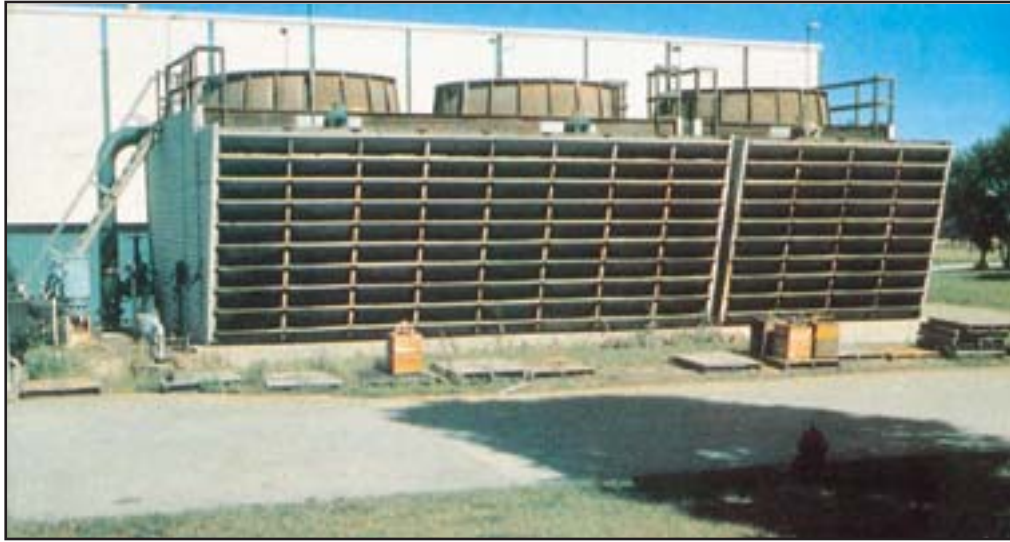
TİPİK MAZGALLI SOĞUTMA KULESİ
